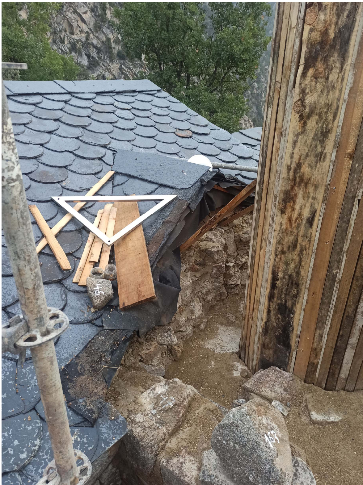
Fotografia 35. Detall de l'encontre del campanar reconstruït amb la coberta de l'església abans de la substitució de les seves lloses
