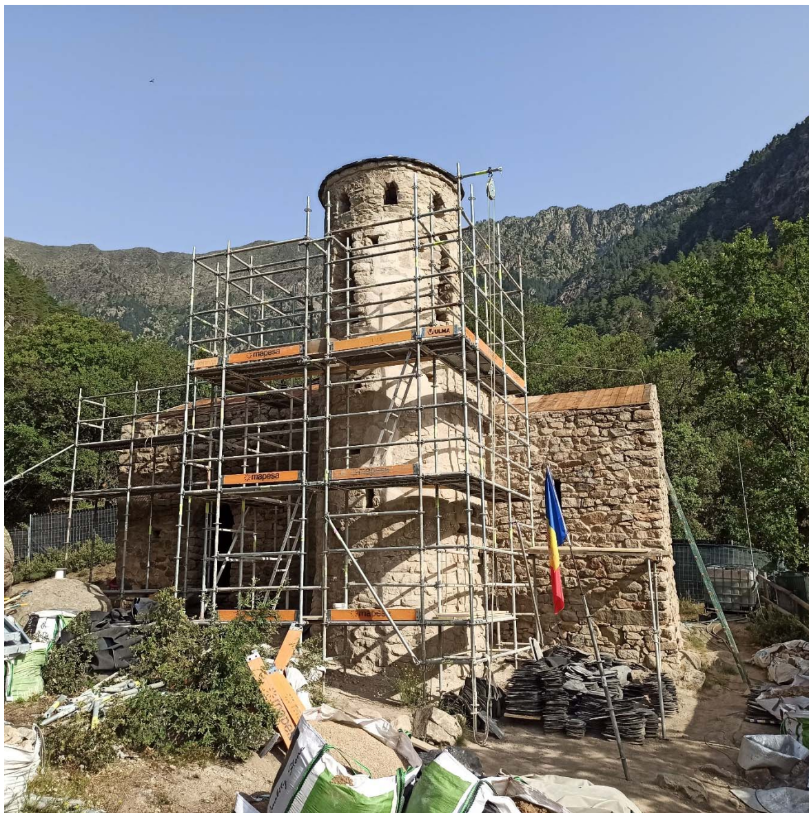
Fotografia 67. Vista general del campanar reconstruït en un moment proper al desmuntat de la seva bastida
