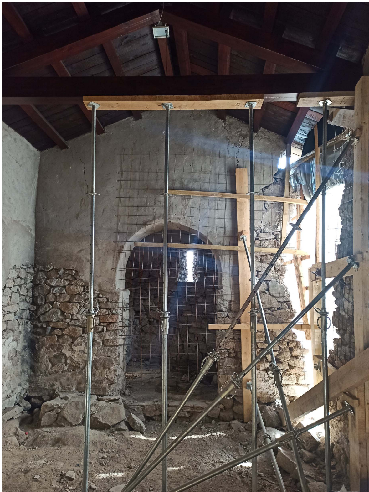
Fotografia 5. Aspecte de l'interior de la nau amb el forat provocat al tancament lateral sud, per la caiguda del campanar
