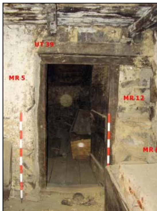
Vista de la cala P4-I. S'observa el trencament de Mr 5 i el recolzament de MR 12 en MR 6
