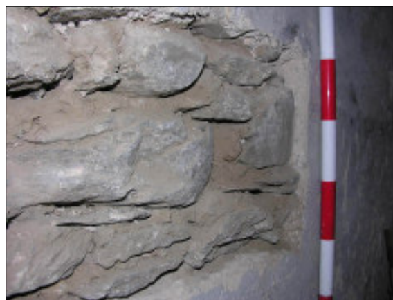
Fig. 103. Detall de la cala 9, on es pot observar l'acabat de l'arrebossat 2008.
