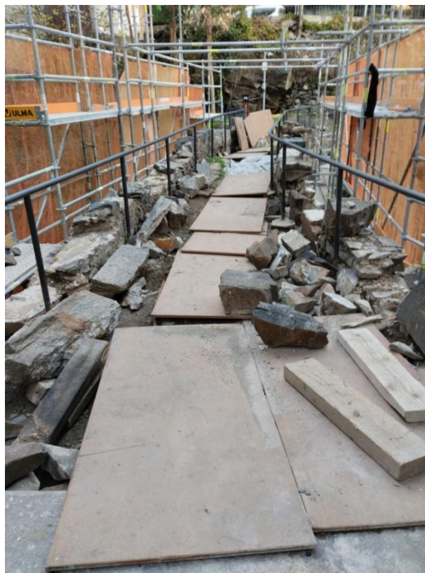
Estat dels murs després desmuntatge sense permís. Vist des del sud
