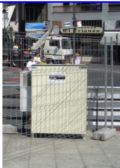
Imatge de l'estació d'òxids de nitrogen
