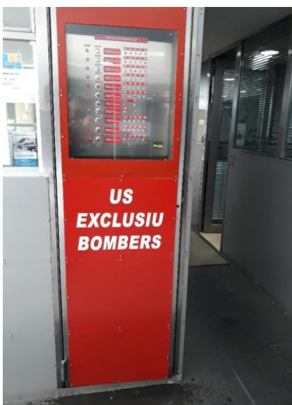
Sistema de control de fums
