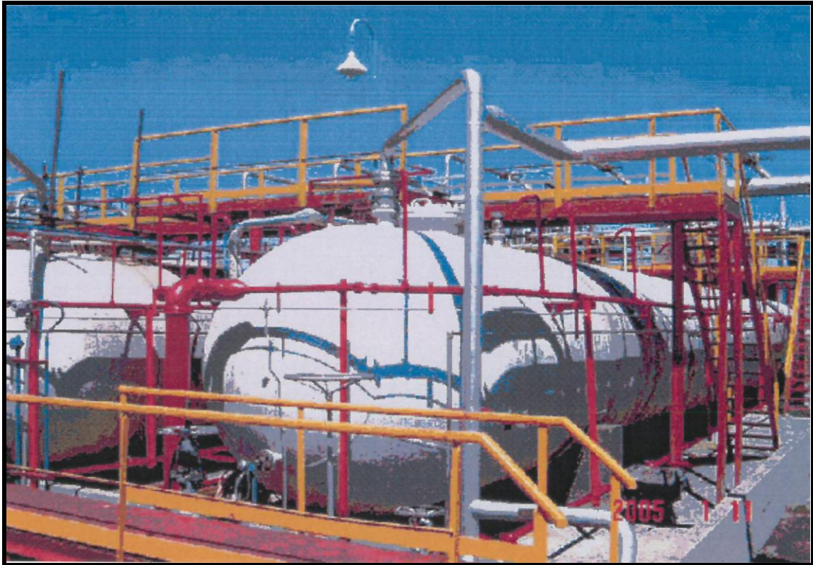
Protecció d'un dipòsit d'emmagatzematge de gas
