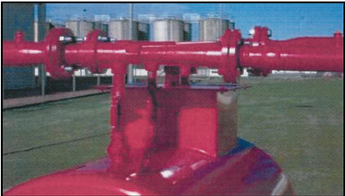
Dipòsit d'escuma amb prebarrejador
