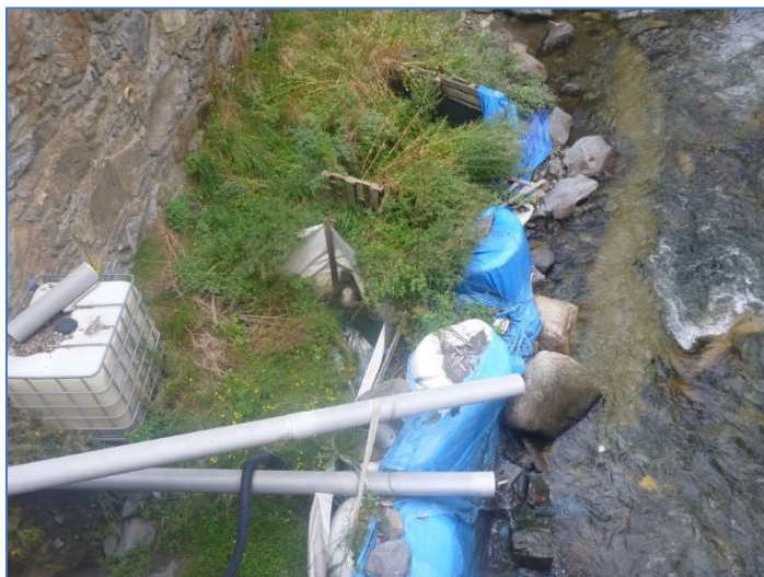
Fotografia 78.- Estructura de retenció d'hidrocarburs sota el pont d'Ordino
