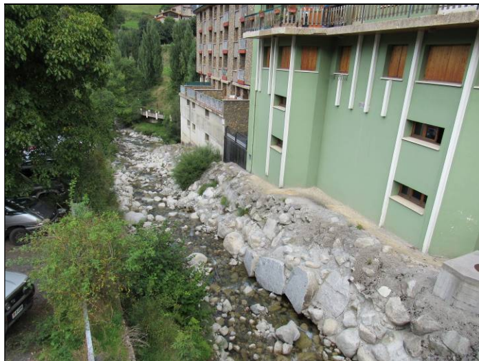
Fotografia 14.- Alteració profunda dels marges amb ocupacions i col·lectors al tram final
