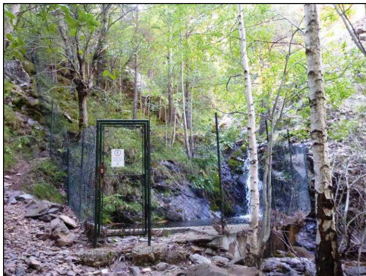
Fotografia 33.- Captació al riu del Coll de l'Aquell
