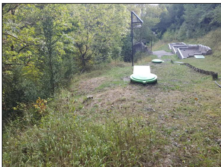
Fotografia 7.- Detall de la depuradora de Fontaneda
