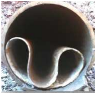
Col·lapse de la mànega (Selvakumar et al., 2014)
