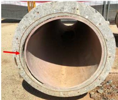
Pèrdua de contacte (mànega semi estructural i sense preliner)
