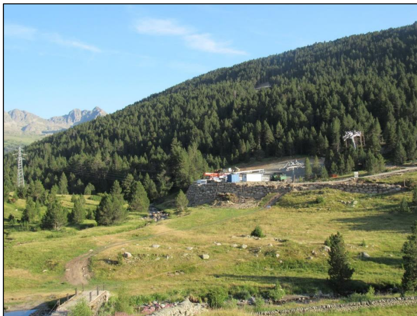
ZH 02121028: Destrucció de la zona humida de Planell de la Palanca 1 per la construcció de la base d'un telecadira
