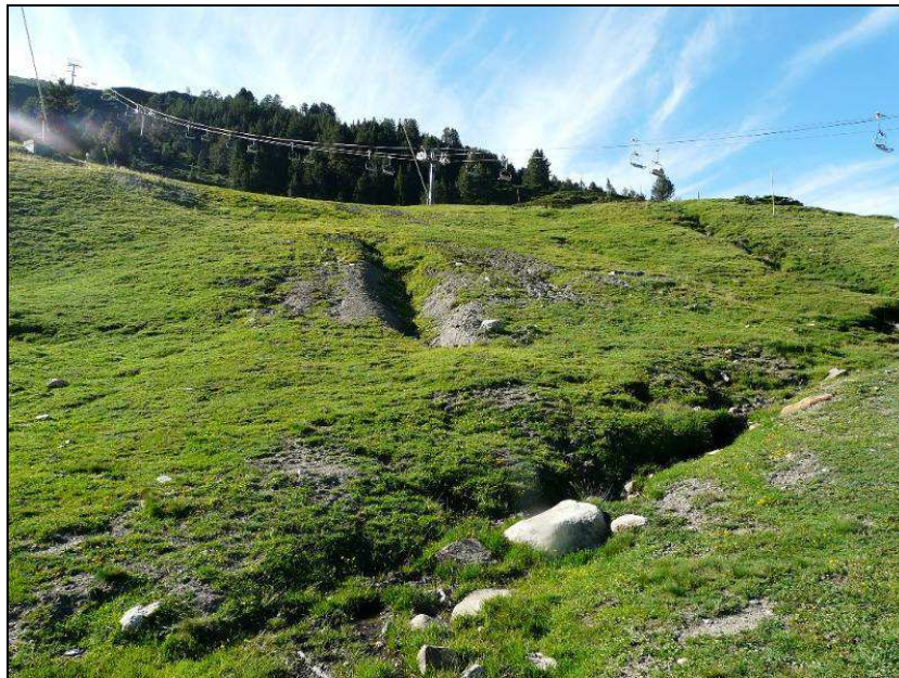
Afectacions de la mollera La Comella 6 (02123018) per les obres de la pista d'esquí
